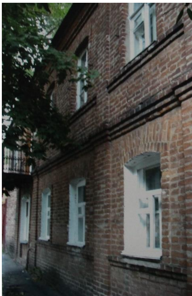
33. Курск, ул. Семеновская, 17. Направление съемки: север. «Дом жилой». Конец XIX – начало XX вв. Фотограф Н.Л. Спиридонова. 2008 г.
