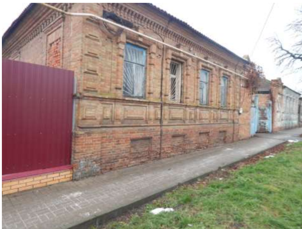
Т.ф. 2. Отдельные элементы декоративного убранства главного фасада Объекта со стороны ул. Комсомольской.
