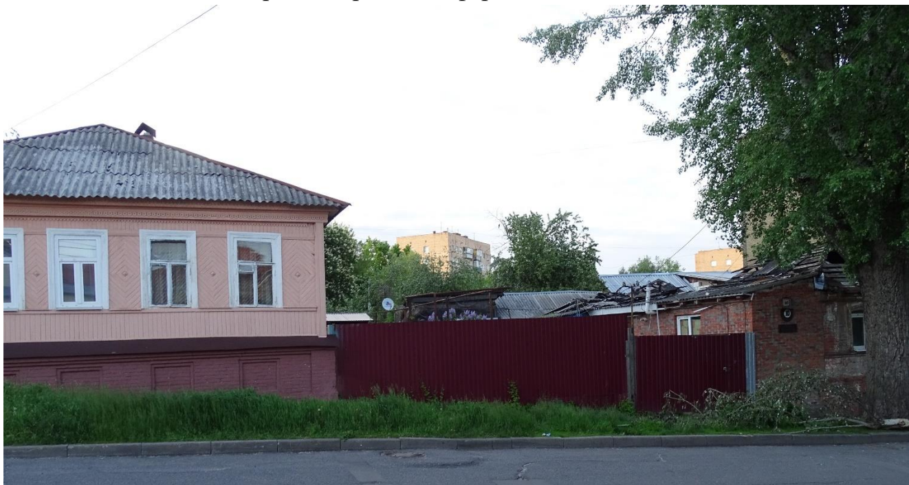
Справа от Объекта – дом №10 по ул. Челюскинцев с полуразрушенной крышей.
