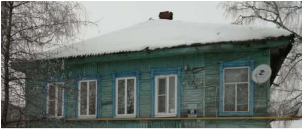
Выявленный объект культурного наследия «Дом жилой, кон. XIX – нач. XX вв.» по адресу: Курская обл., г. Щигры, ул. Комсомольская, д.18. Фрагмент главного фасада, второй этаж. Оконные рамы из ПВХ-профиля. Фото Т.С.Старцевой, февраль, 2022 года.
