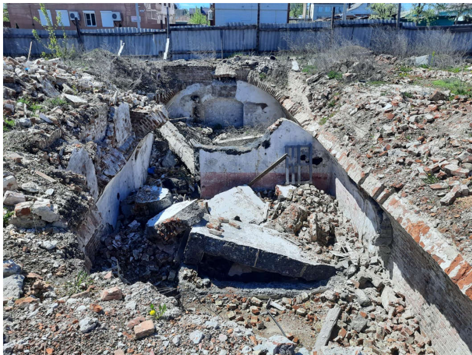
Рис. 21. Вид на фрагменты арочных перекрытий погреба с востока. Фото Оболенской Н.С. Май 2021 г.
