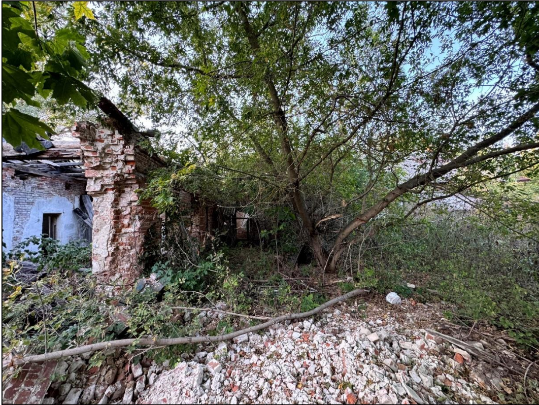
Т.Ф.43. Вид с северо-востока на руины объекта культурного наследия Рабочие казармы
