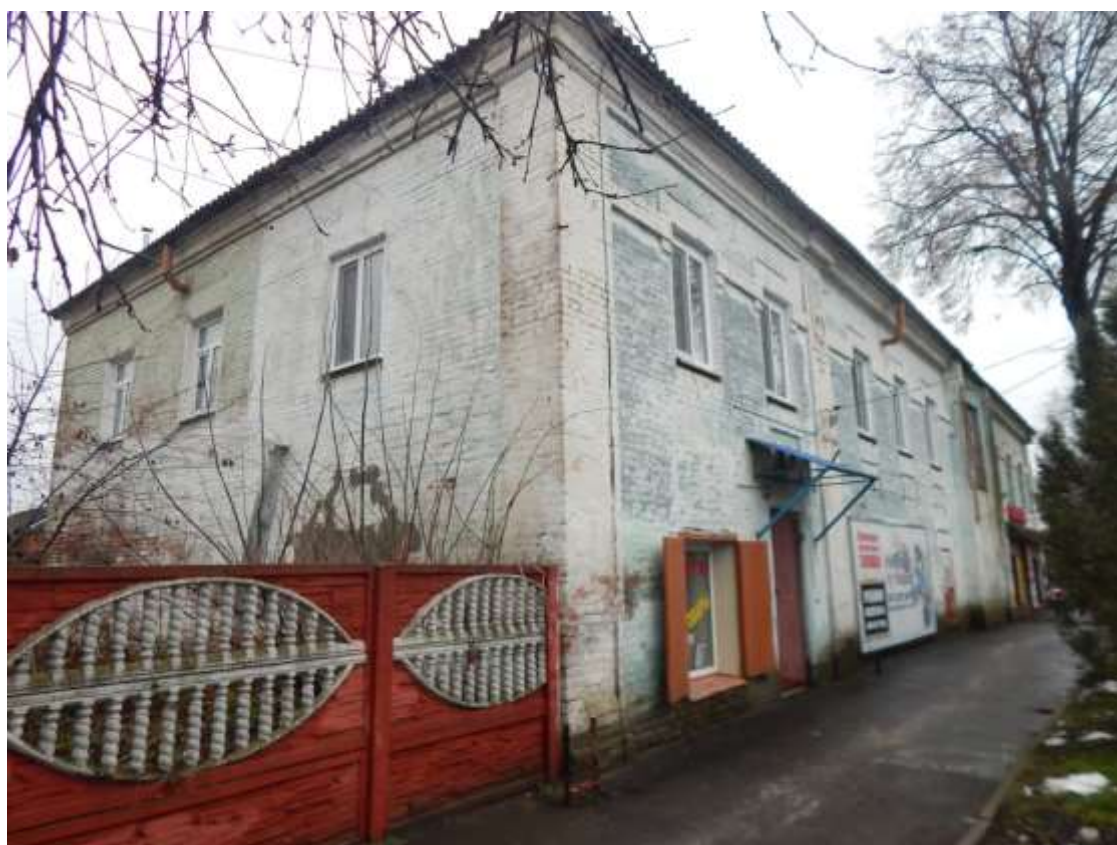
Т.ф. 2. Общий вид главного и бокового фасадов Объекта со стороны ул. 1 Мая.
