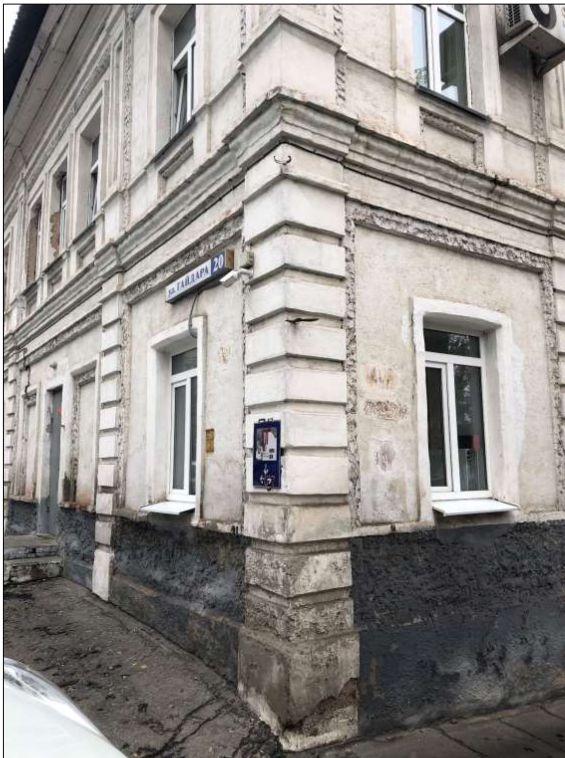
Вид с юго-запада по улице Гайдара на Объект. Западный и южный фасады
