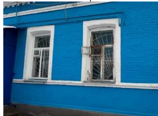
Расстекловка оконных проемов бокового фасада
