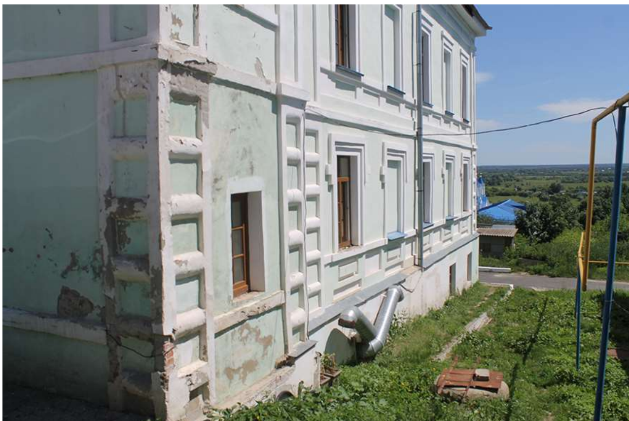
Т.ф. 8. Отдельные элементы декора фасадов Объекта
