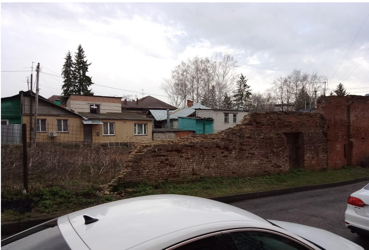
Фото 11. Усадебная застройка вдоль северной границы домовладения №26 по ул. К. Либкнехта на фоне полуразрушенной брандмауэрной стены.
