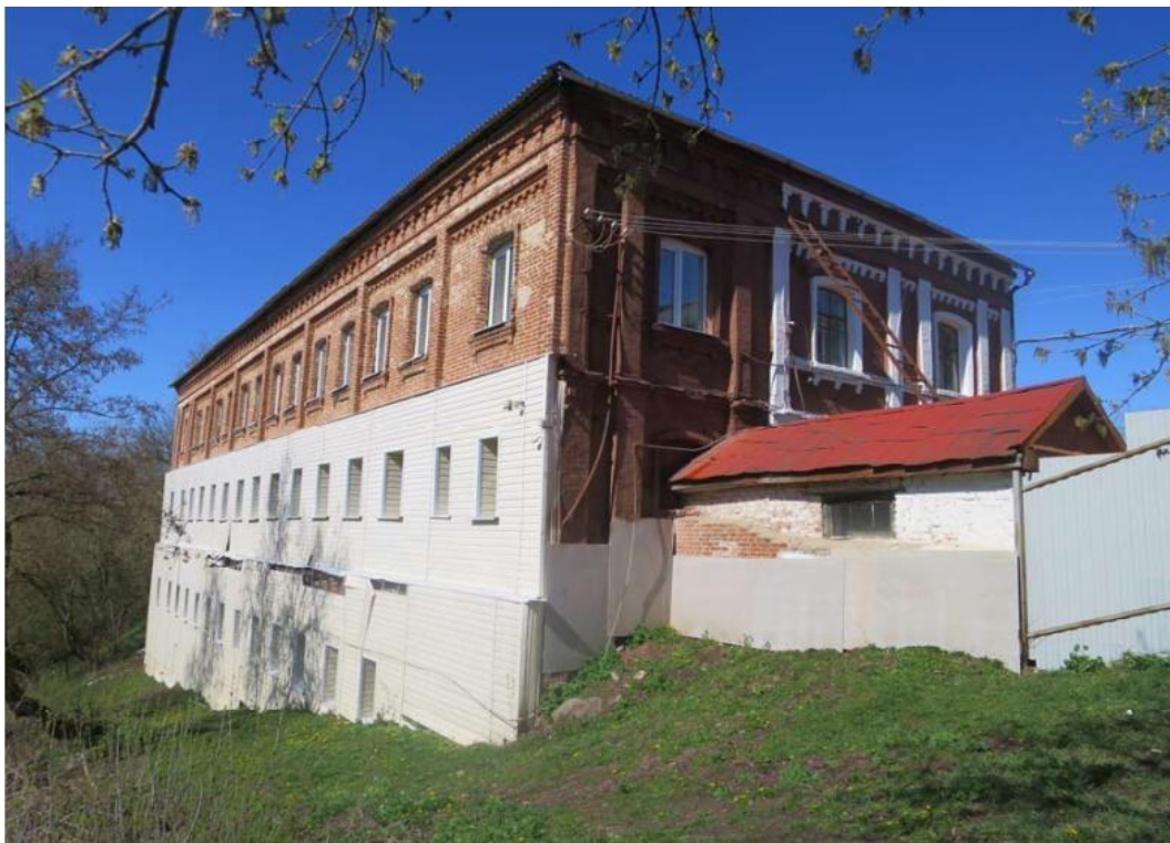
Вид с востока на ОКН регионального значения «Келейный братский корпус с трапезной», конец 1880-х гг., (г. Обоянь, ул. Жукова, 2). Примыкание ремонтируемого объекта к объекту культурного наследия регионального значения «Келейный братский корпус с трапезной», конец 1880-х гг
