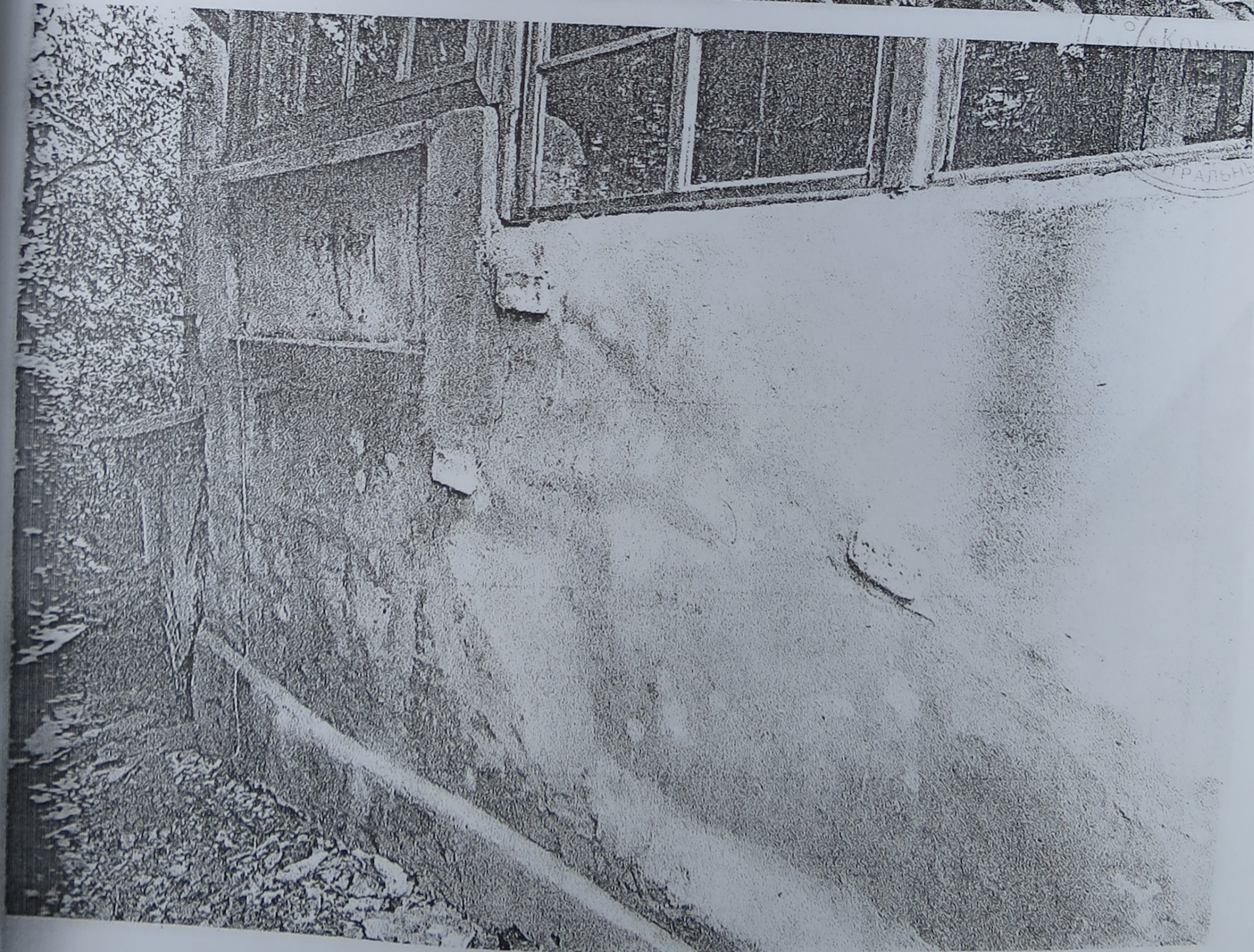
ФОТО 18. Состояние входного тамбура. Просадка
