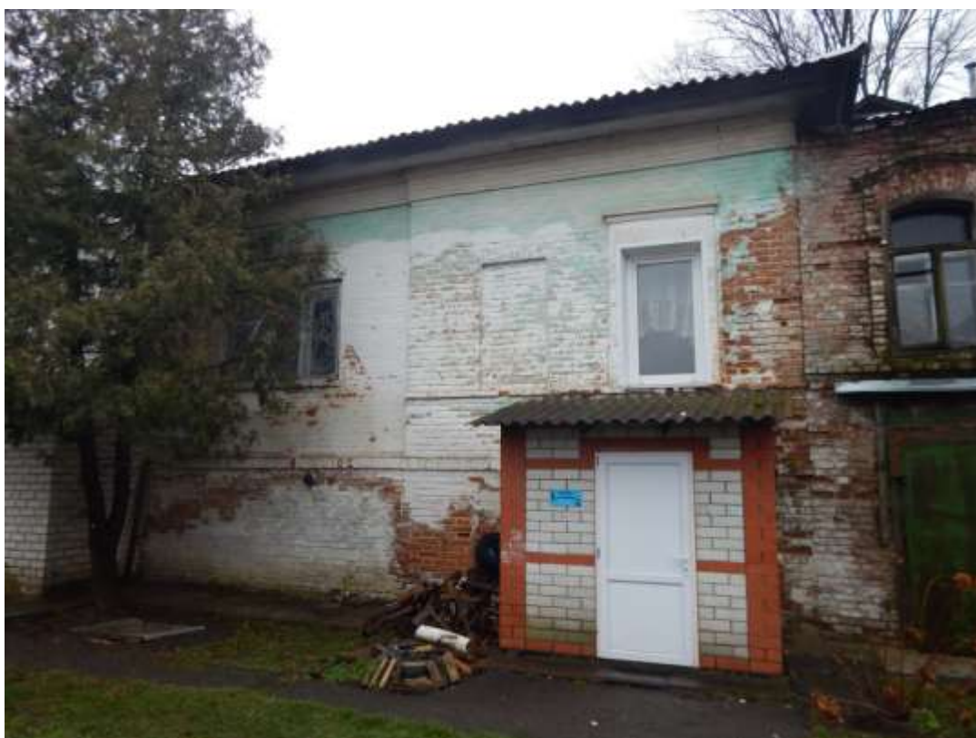
Т.ф. 4. Боковой фасад Объекта со стороны ул. Щепкина.
