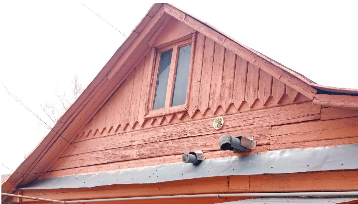
Фото 20. Выявленный объект культурного наследия «Флигель», г. Курск, ул. Карла Либкнехта, 30а. Фрагмент Западного фасада. Фото Коротеевой Е.В. 11.11.2024 г.
