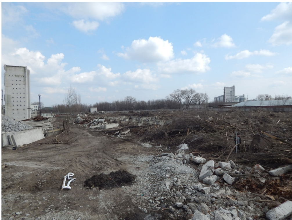
Илл. 33. КРО-2021. Г. Курск. Просп. Кулакова. Общий вид участка обследования. Точка № 5. Снимок № 5. Вид с ЗЮЗ.
