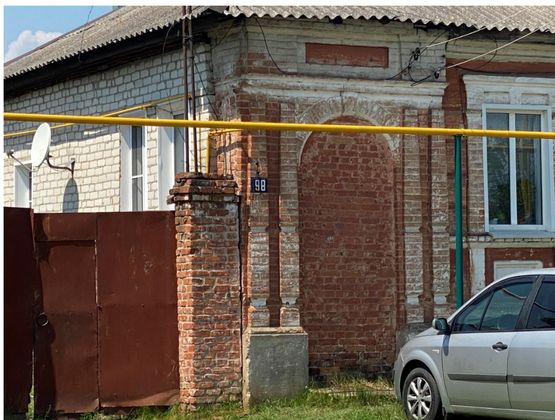
Фотография № 10. Вид с юго-востока на Объект. Угол южного и восточного (центрального) фасадов.
