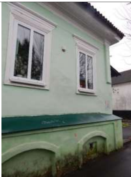
выступающий из плоскости фасада цокольный этаж, полуокна с прямоугольным гладким обрамлением и лучковым завершением
