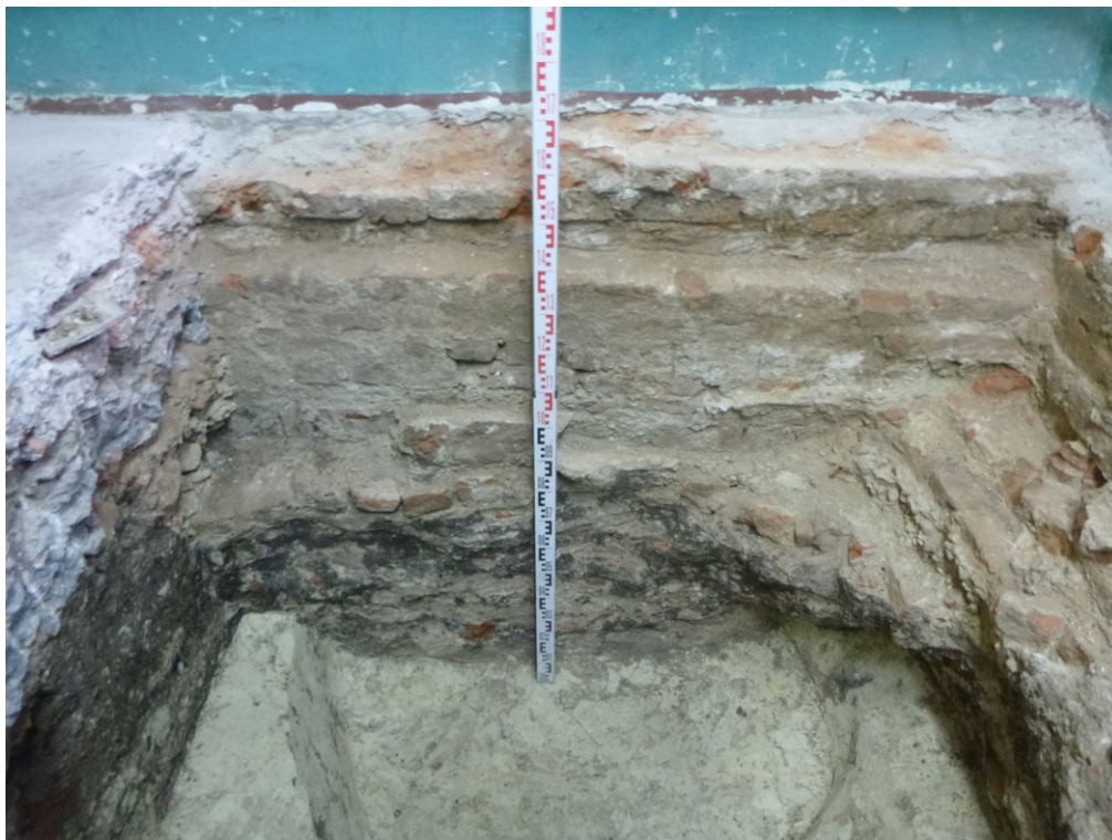
Рис. 44. Проведение работ по приспособлению к современному использованию объекта: «Экспозиционный корпус Курского областного краеведческого музея в объекте культурного наследия регионального значения «Здание мужской классической гимназии, 1836-1842гг.», расположенном по адресу: Курская область, г. Курск, ул. Луначарского, 8, здание литер В». 2022 г. Шурф 3. Юго-восточный борт. Вид с СЗ (разведочные работы С.Н. Головина, 2020 г.).
