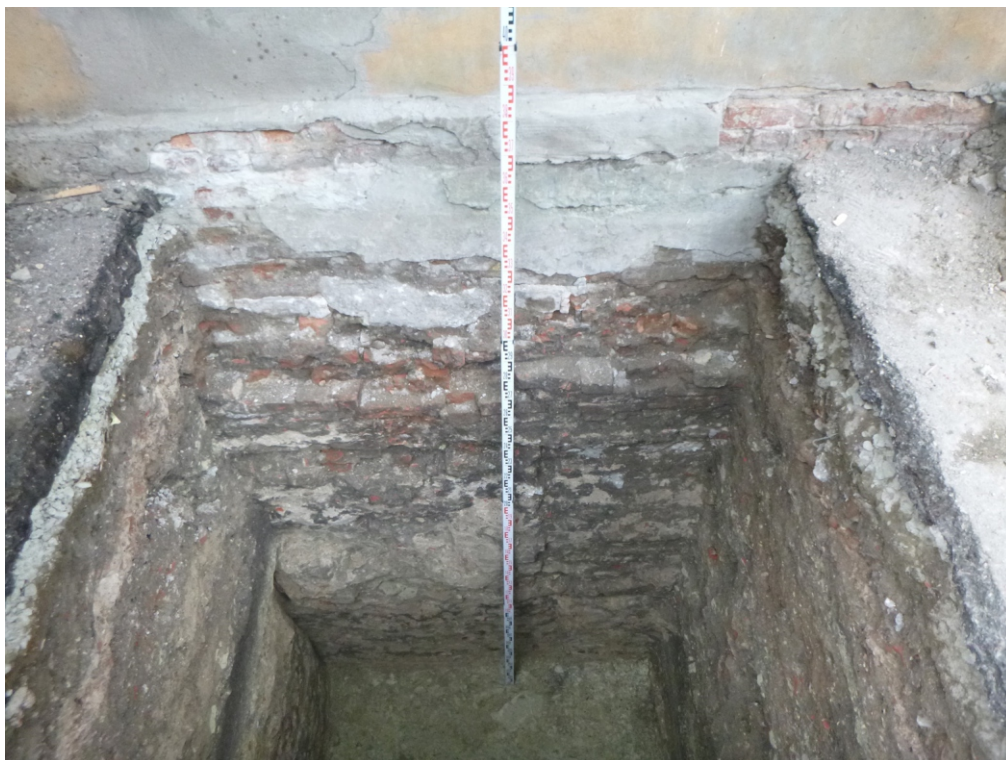
Рис. 38. Проведение работ по приспособлению к современному использованию объекта: «Экспозиционный корпус Курского областного краеведческого музея в объекте культурного наследия регионального значения «Здание мужской классической гимназии, 1836-1842гг.», расположенном по адресу: Курская область, г. Курск, ул. Луначарского, 8, здание литер В». 2022 г. Шурф 2. Северо-восточный борт. Вид с ЮЗ (разведочные работы С.Н. Головина, 2020 г.).
